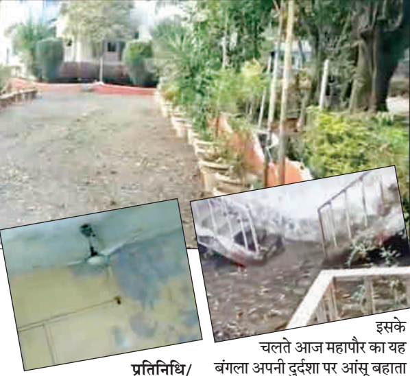
इसके चलते आज महापौर का यह बंगला अपनी दुर्दशा पर आंसू बहाता हुआ ही नजर आ रहा है. यहां के दरवाजे टूटे हैं, पेंट उखड़ा पड़ा है और परिसर में कचरा ही कचरा नजर आ रहा है.
